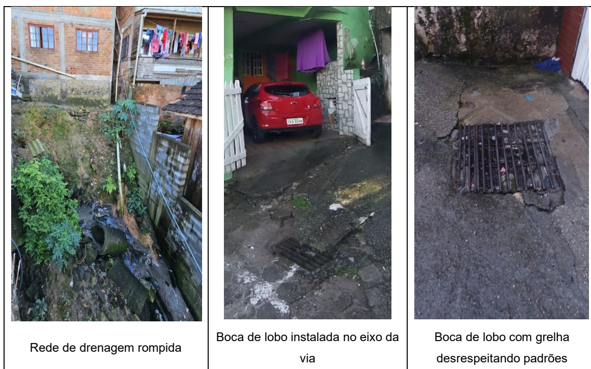
Quadro 3 – Registro fotográfico problemas de drenagem
