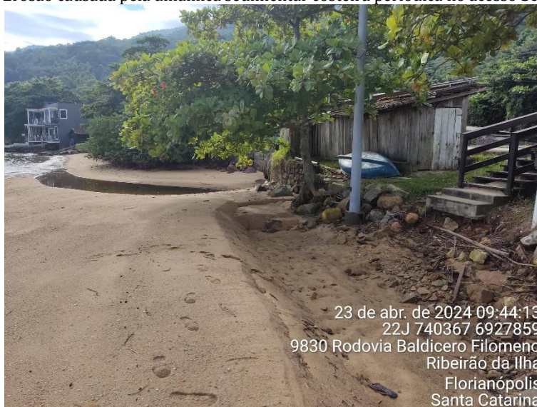
Figura 97. Erosão causada pela dinâmica sedimentar costeira periódica no acesso S07_P23_A07 .
