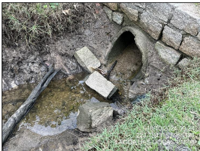
Figura 107. Estrutura de drenagem, em rua do bairro, nas proximidades de uma passarela com escoamento superficial desaguando em direção ao manancial.
