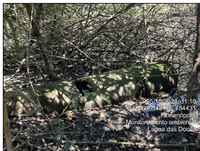
Figura 113. Precariedade de estrutura de drenagem, com tubulações quebradas e aflorante; estrutura de drenagem "afogadas" em área de manguezal bem como com possível lançamento clandestino de esgoto doméstico.
