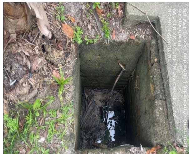
Figura 106. Precariedade da estrutura de drenagem, em rua do bairro, nas proximidades de uma passarela que vai em direção à área de praia.
