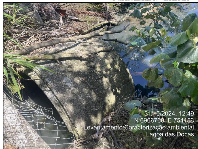
Figura 127. Detalhamento da estrutura da imagem anterior. Além de possível esgotamento sanitário, a estrutura encontra-se com partes quebradas.
