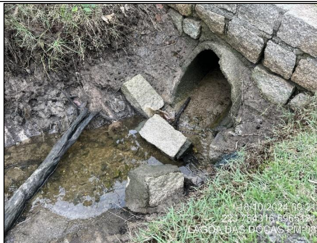
Figura 253. Tubulação de drenagem com saída de águas; escoamento em direção ao rio da imagem anterior.
