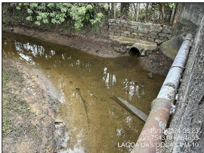
Figura 99. Estrutura de drenagem desembocando no rio Sanga dos bois. Observado mau cheiro e coloração escura de suas águas com indícios de esgotos. Sem chuvas no momento da vistoria.
