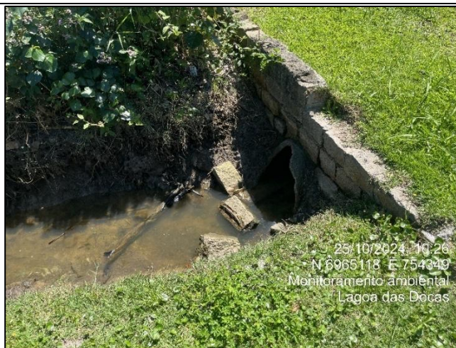
Figura 261. Tubulação de drenagem com saída de águas; escoamento em direção ao rio da imagem anterior.
