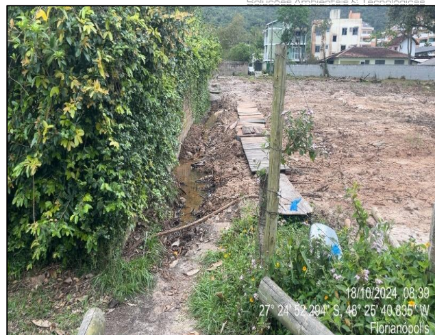
Figura 100. Precariedade de estrutura de drenagem, com tubulações quebradas e aflorando ao lado de um terreno particular.
