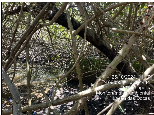
Figura 114. Precariedade de estrutura de drenagem, com tubulações quebradas e aflorante; estrutura de drenagem "afogadas" em área de manguezal bem como com possível lançamento clandestino de esgoto doméstico no ponto.
