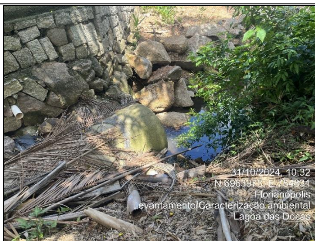
Figura 300. Espaço construído em cima do rio. Canalização sobre o manancial causando problemas na área.
