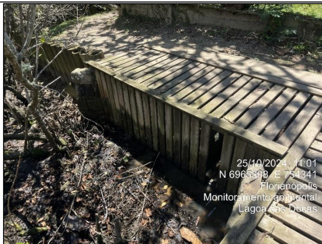
Figura 264. Tubulação de drenagem coberta com madeiras; escoamento com vazão constante e em direção ao manancial com área de mangue.
