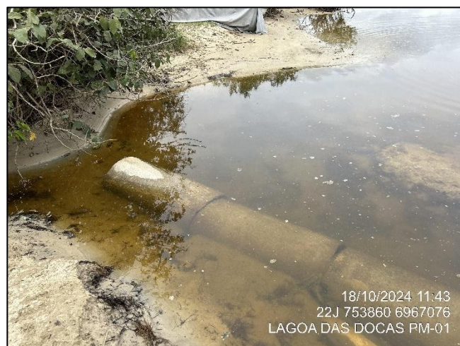
Figura 129. Estrutura de drenagem da imagem anterior sobre a área da praia com escoamento amplo, tanto para a praia quanto para a lagoa. Formação de uma área empoçada.
