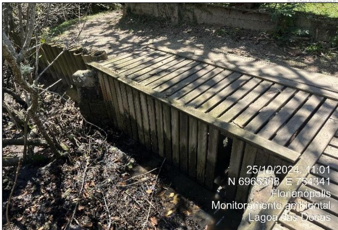
Figura 111. Estrutura de drenagem coberta com base de madeiras. Possível lançamento irregular de esgoto doméstico nesse ponto na rede de drenagem de águas pluviais.
