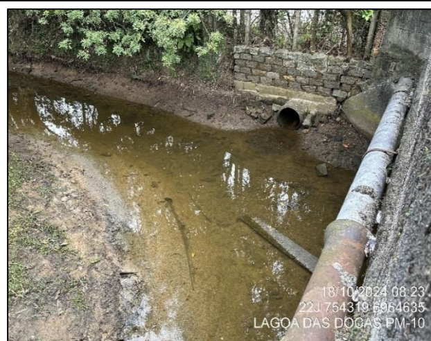
Figura 245. Tubulação com saída de água mais escura desaguando no manancial.
