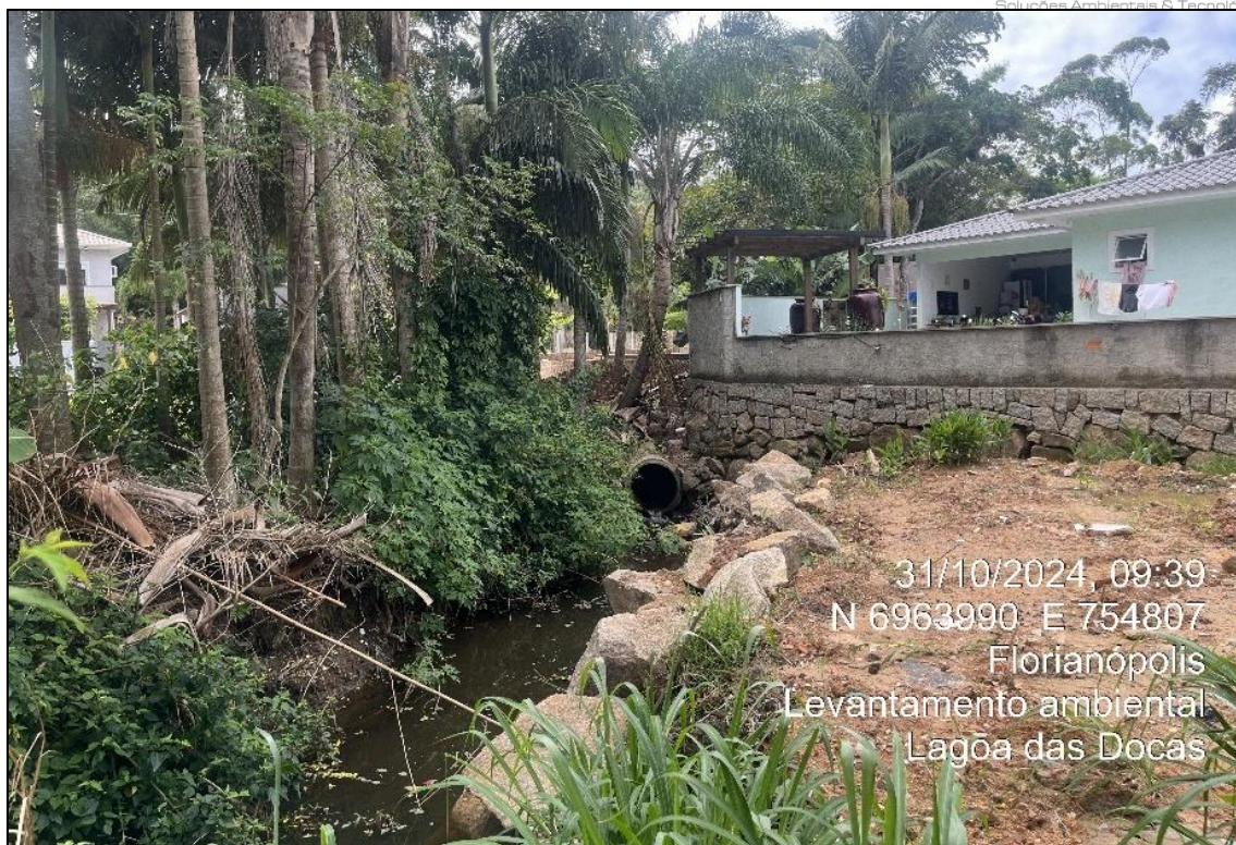
Figura 293. Rio canalizado sobre casa.
