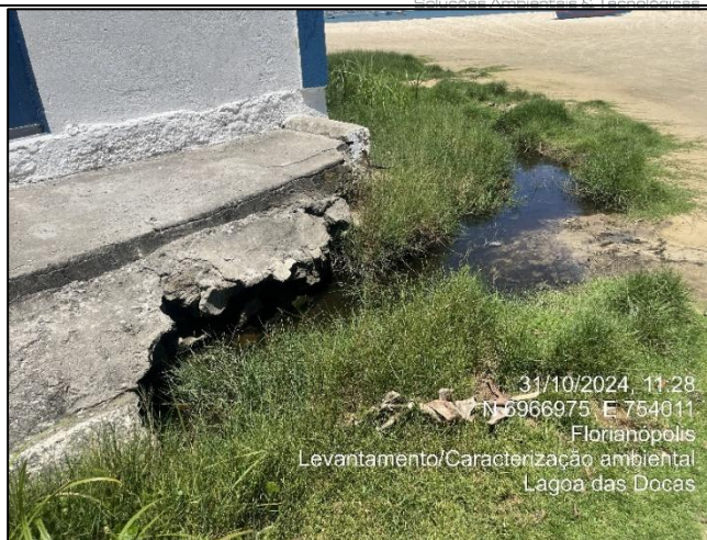
Figura 310. Águas de drenagem e de lavagem de embarcações empilhadas, mas com escoamento para a área da lagoa
