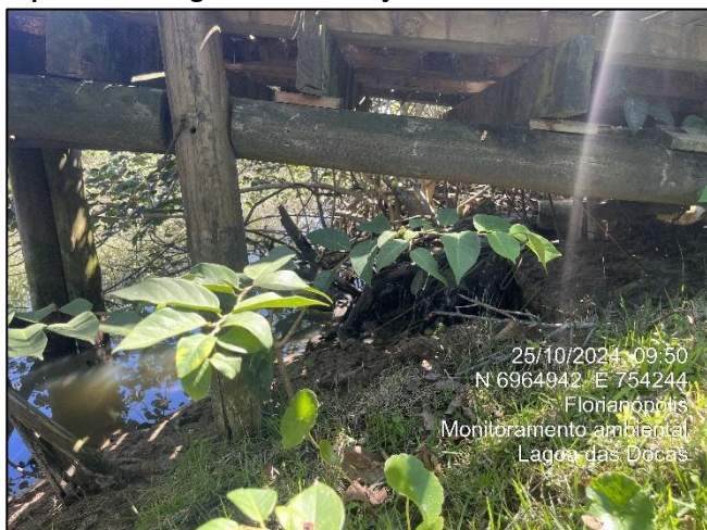
Figura 109 Possível lançamento clandestino de esgoto doméstico na rede de drenagem de águas pluviais.
