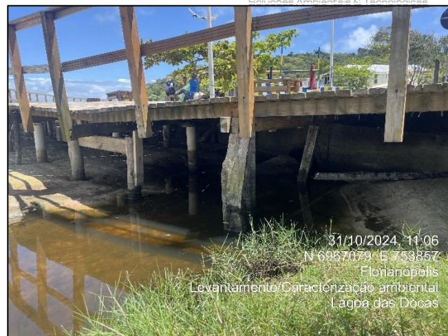
Figura 131. Estrutura de drenagem rompida. Mesma área das imagens anteriores. Apresenta forte odor de esgoto. Local ao lado do Deque da Praia Ponta das Canas. De acordo com pessoas do local, a canalização recebe águas pluviais bem como de nascentes canalizadas ao longo do trecho e de pontos mais altos do bairro.
