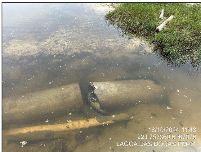
Figura 130. Estrutura de drenagem rompida. Mesma área das imagens anteriores.
