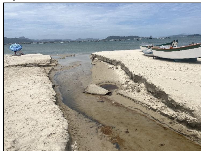
Figura 133. Abertura feita por ação antrópica, para escoamento do sistema de drenagem.
