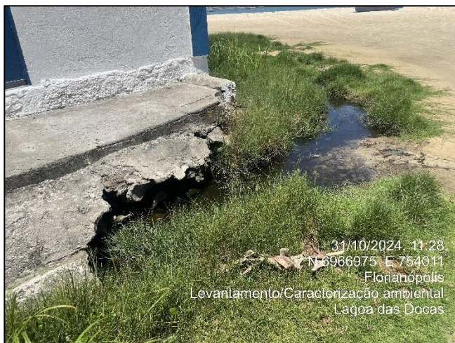
Figura 122. Estrutura de drenagem danificada, com escoamento indo em direção à Lagoa das Docas. Ponto com mistura de águas de lavagens de embarcações de estabelecimento particular.
