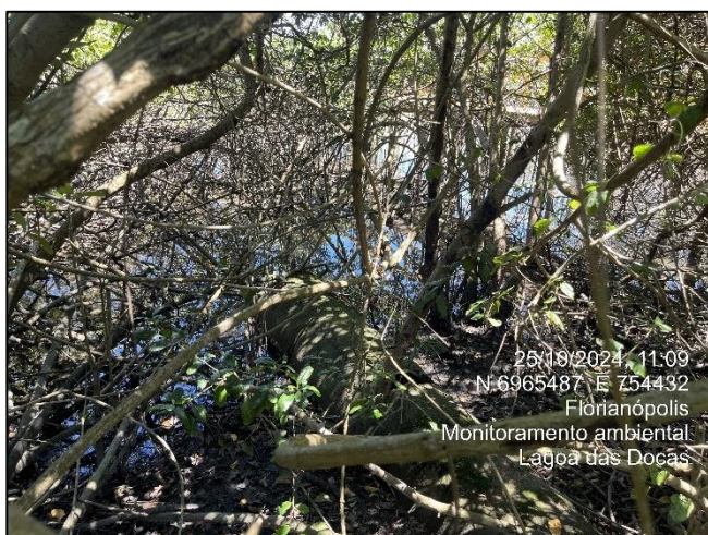
Figura 112. Precariedade de estrutura de drenagem, com tubulações quebradas e aflorante; estrutura de drenagem "afogadas" em área de manguezal bem como com possível lançamento clandestino de esgoto doméstico.
