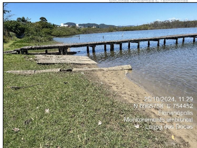
Figura 115. Precariedade de estrutura de drenagem com deságue para a área da lagoa.
