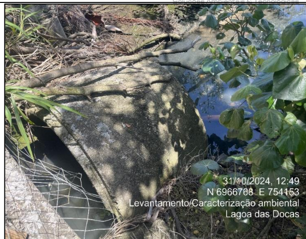
Figura 316. Vazão alta de esgotos sendo direcionada para a área da Lagoa das Docas.
