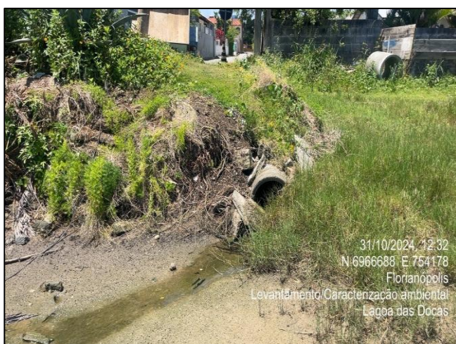
Figura 124. Canalização de drenagem de águas com saída direta para a Lagoa das Docas.
