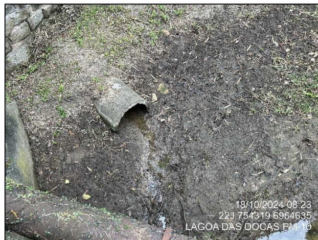
Figura 98. Estrutura de drenagem afogada com excesso de sedimento na tubulação. Escoamento em direção ao rio Sanga dos Bois.
