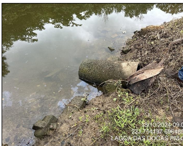
Figura 105. Precariedade da estrutura de drenagem.
