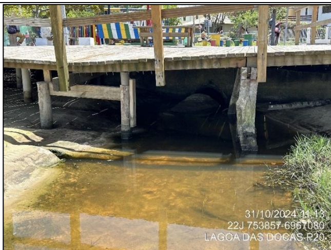
Figura 301. Tubulação de drenagem com direcionamento para a área do mar; canalização com possíveis nascentes oriundas de partes mais altas do bairro.
