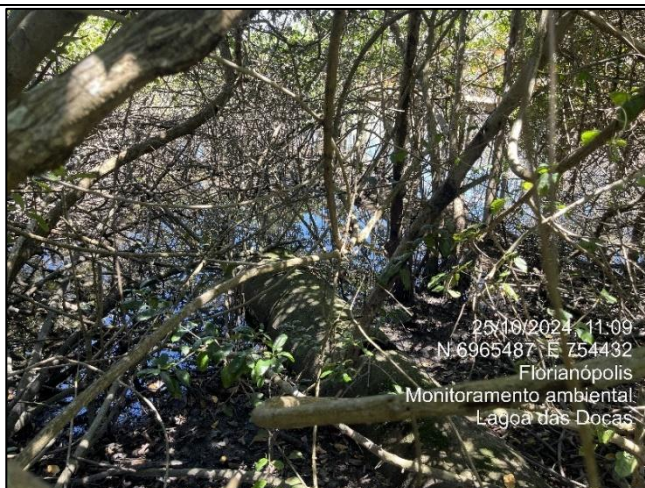
Figura 265. Tubulação de drenagem com grande diâmetro; escoamento com vazão constante e em direção ao manancial e área de mangue.
