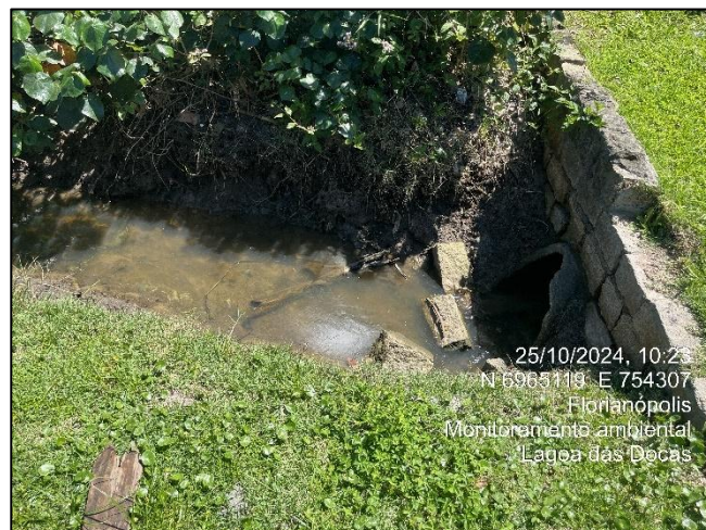
Figura 110. Escoamento de rede de drenagem. Local com certo refluxo na rede, pois em alguns momentos parte da água retornava para a tubulação.
