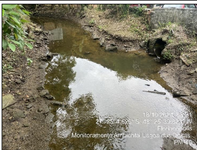
Figura 244. Leito do rio com presença de entulhos, assoreamento e canalização de drenagem e ou esgotamento. No momento da vistoria, ficou constatada a saída de água mais escura da tubulação, podendo ser de esgotos.
