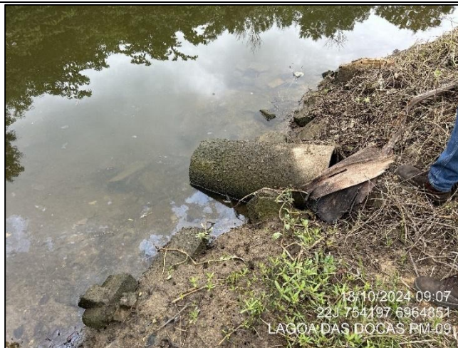
Figura 251. Manchas de óleo na superfície do rio e tubulação de drenagem rompida.
