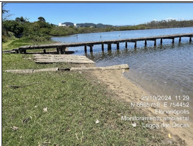
Figura 269. Tubulação de drenagem com direcionamento para a lagoa; canalização com problemas.
