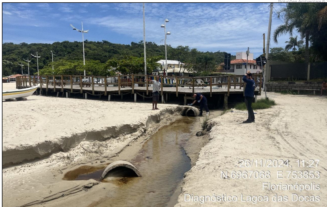
Figura 134. Situação da área das imagens anteriores. Local usado até para lavagem e pintura de embarcações.
