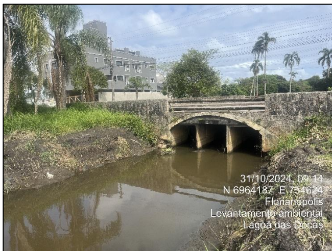
Figura 118. Construção/passagem sobre o rio Sangra bois, em área retificação e residencial na avenida dos Jerivás. No local, saída de canal de drenagem com vazão constante de águas.
