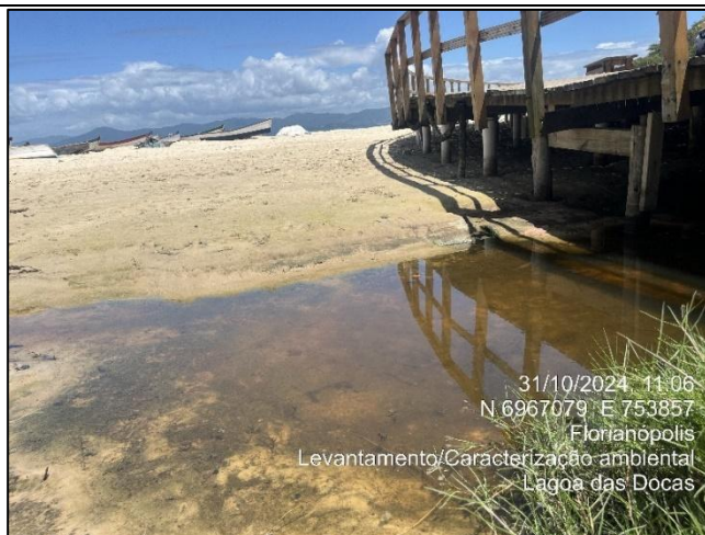
Figura 302. Acumulação de águas no ponto.
