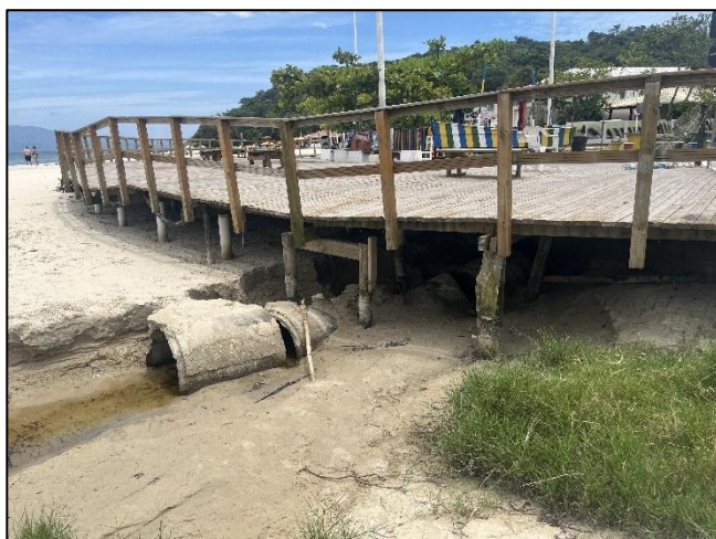
Figura 132. Estrutura das imagens anteriores, no dia 26/11/2024. Rompimento após fortes chuvas.
