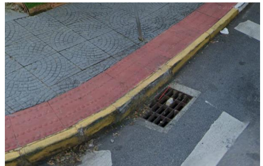
Foto 33 - Drenagem - Rua Pref. Antenor Mesquita.
