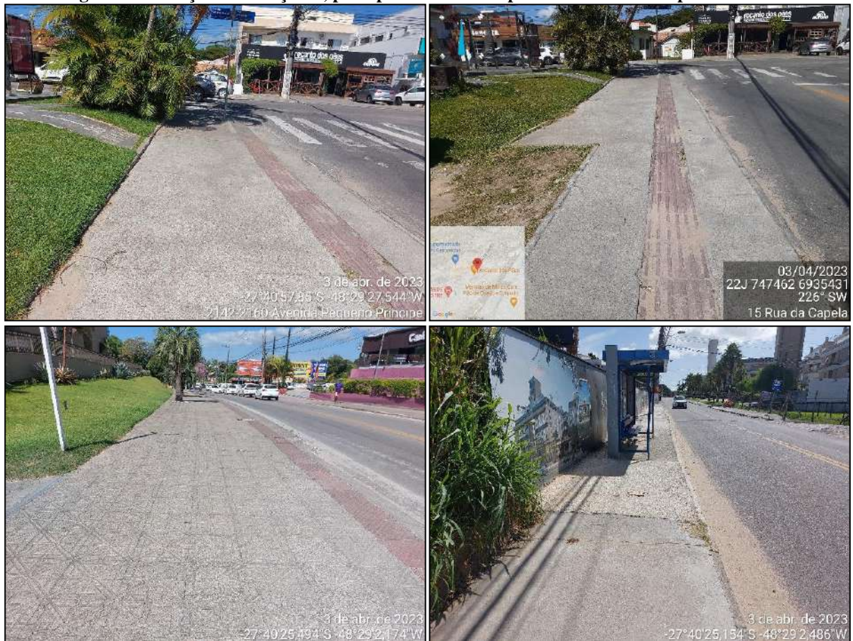
Figura 7. Condições das calçadas, pisos podotáteis e rampas do entorno do empreendimento.
