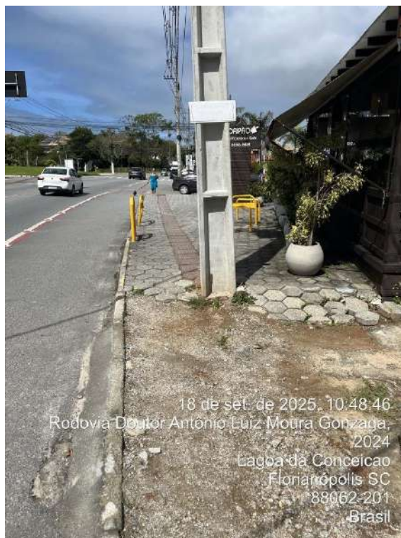
Figura 4.6 – Rodovia Dr. Antônio Luiz Moura Gonzaga (passeio sem acessibilidade e após com acessibilidade).
