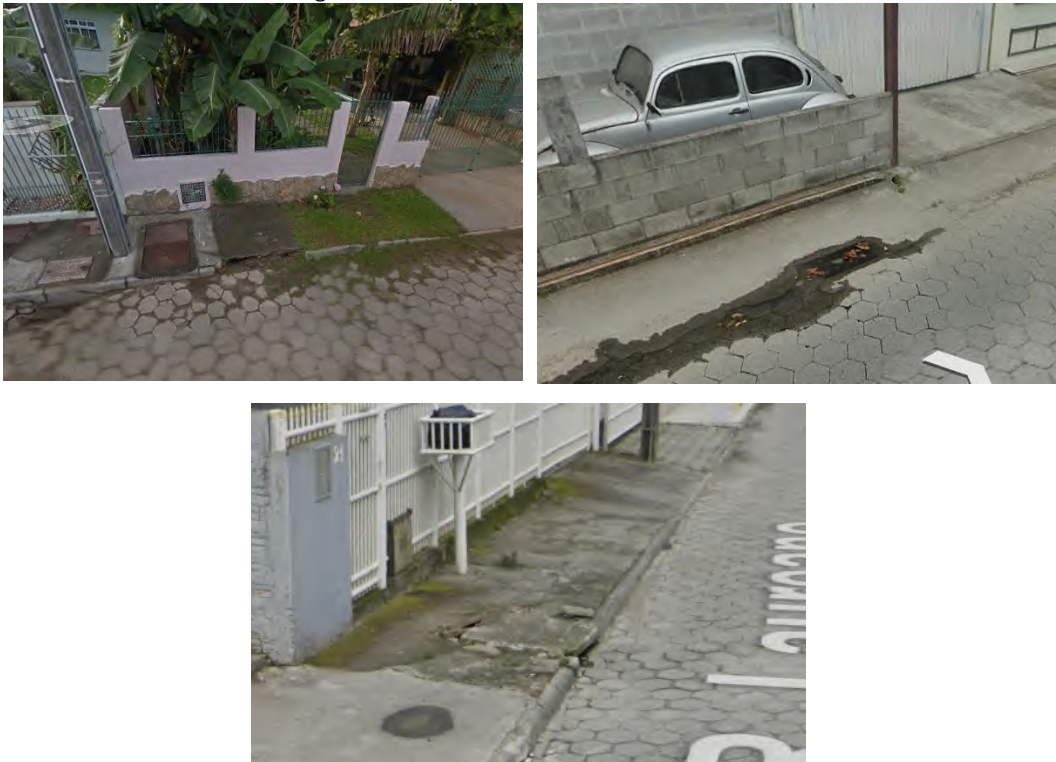
Figura 1: Boca-de-lobo Alameda Augusto Ruschi, bueiro obstruído Rua Jaborandi e boca-de-lobo Rua Laureano
