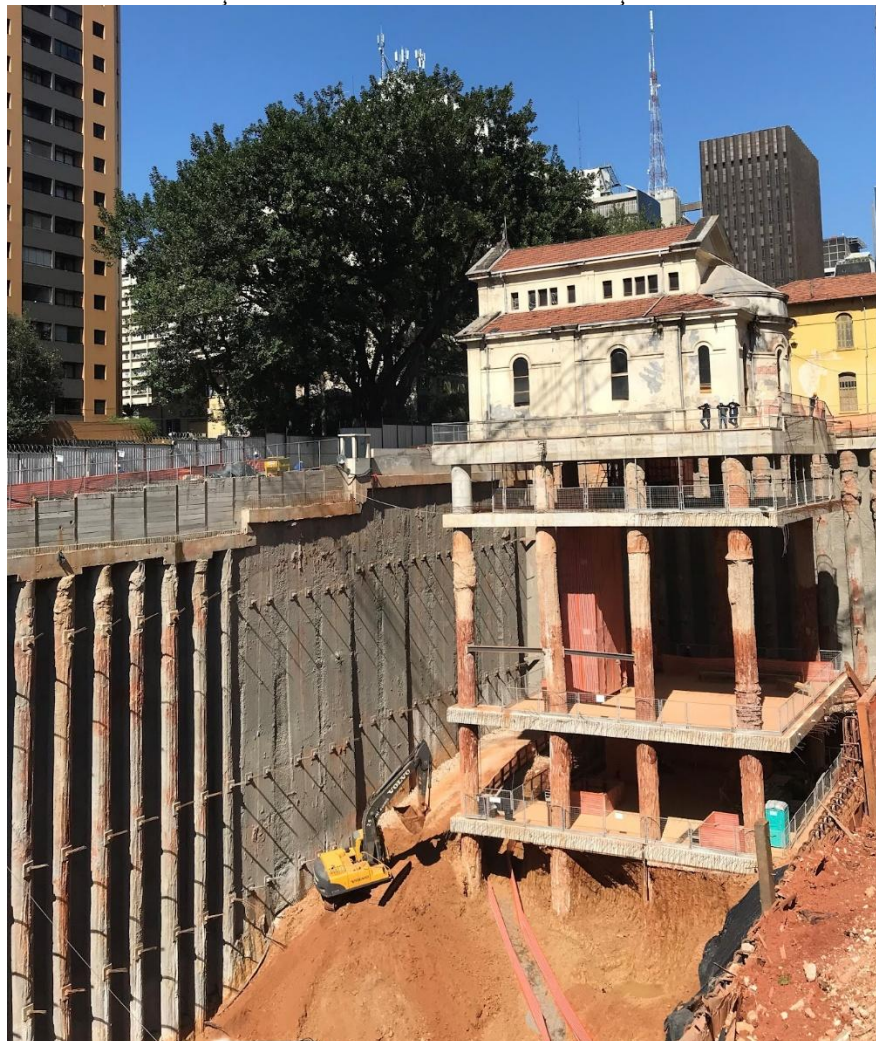
Edificação tombada sobre estrutura de transição
