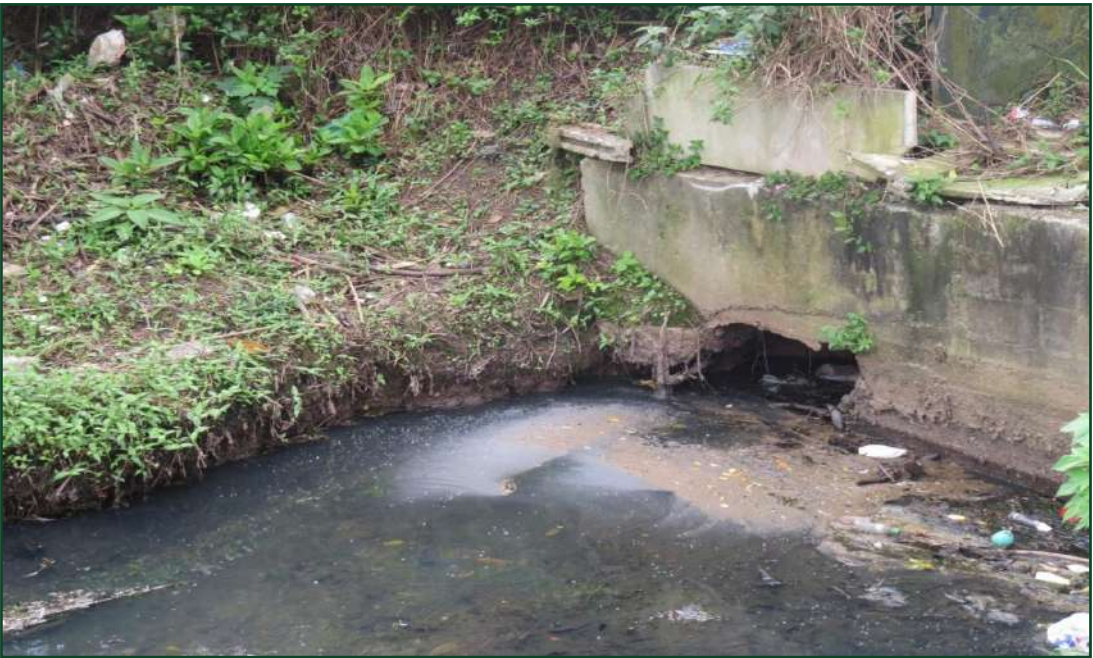
Figura 22: Registro de ponto de lançamento clandestino de efluentes no PNMMI-FM
