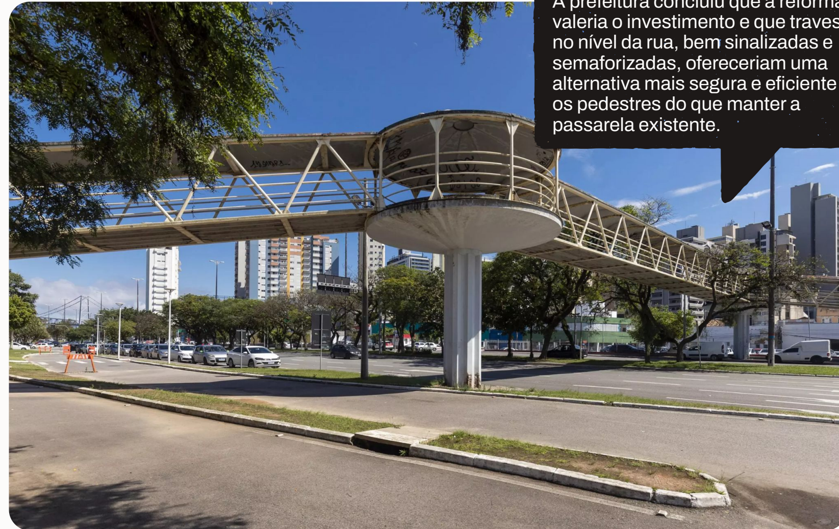
A estrutura antiga já não atendia às necessidades atuais de movimento de pedestres e estava em condições precárias, com ferrugem e deterioração, gerando risco potencial de colapso. Fonte: CBN total
