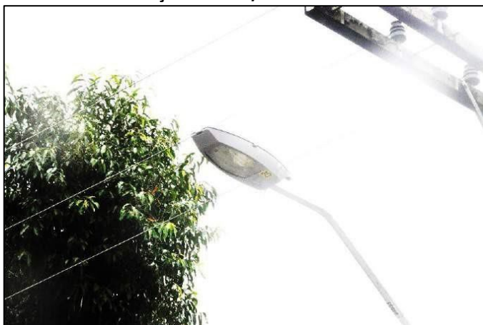
Figura 32. Vista do sistema Iluminação Pública / Rede Elétrica – Estr. Haroldo Soares Glavan.
