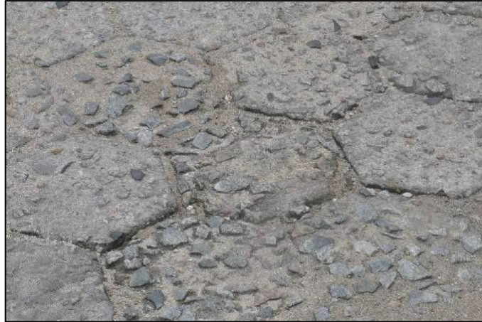
Figura 28. Estrada Antônio Soares Glavan – Trechos pontuais com desgaste de pavimento e exposição dos agregados.
