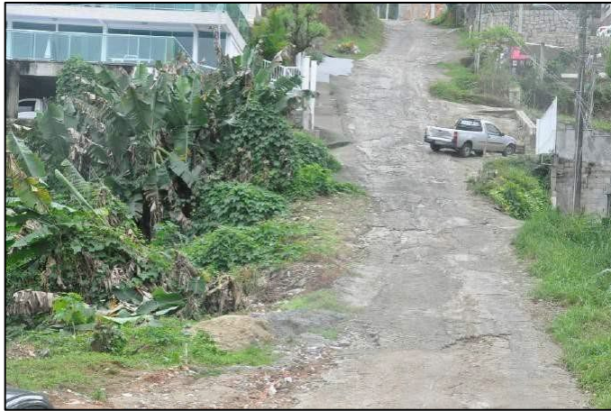
Figura 29. Servidão Antônio Cordeiro – Falta de passeios e pavimento em situações precárias.
