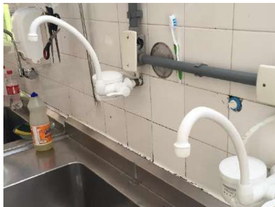
(c) Detalhe para aquecimento de água na cozinha
