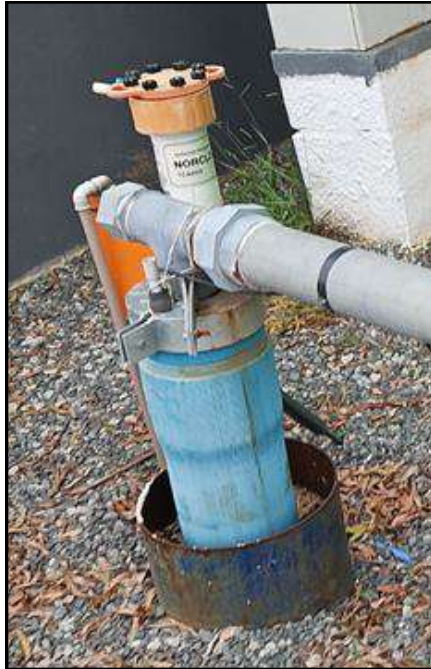
Poço Cruz de Malta. Poço complementar de captação de água subterrânea da CASAN, situado próximo ao campo de futebol na área do empreendimento.
