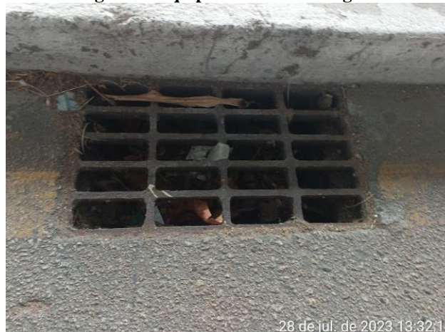
Figura 1. Equipamento de drenagem.
