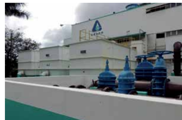
Figura 8.50: Estação de Tratamento de Água
