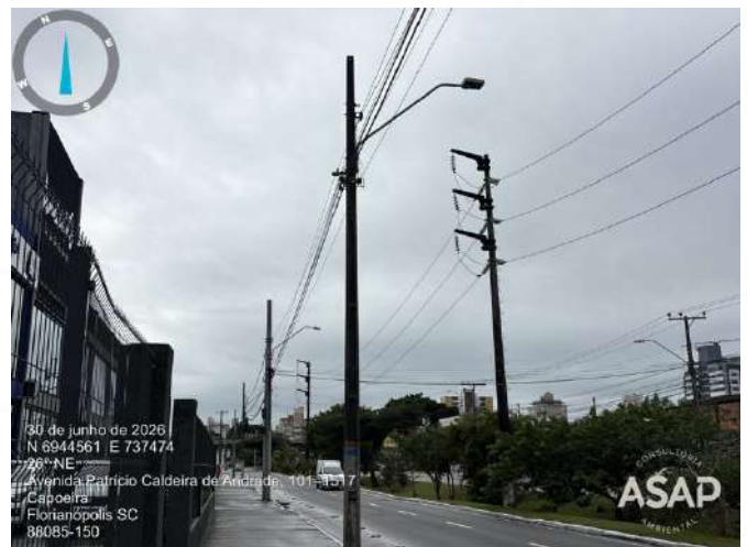
Foto 3.2. Iluminação em LED na Avenida Patricio Caldeira de Andrade. Fonte: ASAP, 2026.
