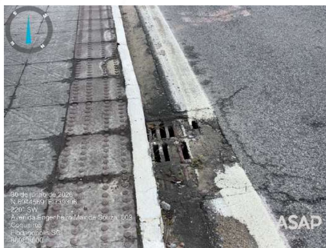
Foto 4.23. Bueiro em mal estado na Avenida Engenheiro Max de Souza. Fonte: ASAP, 2026.
