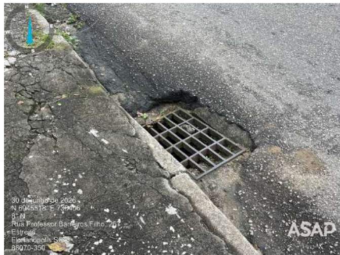
Foto 4.10. Bueiro em mal estado na R. Prof. Barreiros Filho. Fonte: ASAP, 2026.
