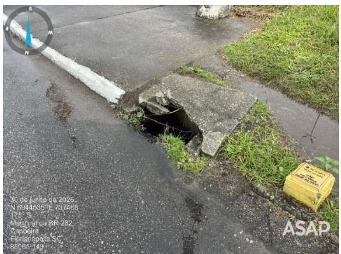
Foto 4.3. Bueiro em mal estado na marginal da via expressa. Fonte: ASAP.
