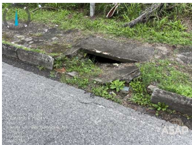
Foto 4.21. Bueiro em mal estado na Avenida Almirante Tamandaré. Fonte: ASAP, 2026.
