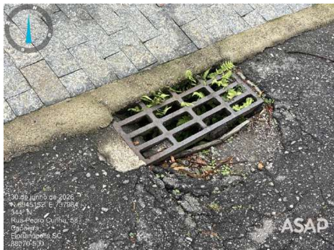
Foto 4.7. Bueiro em mal estado na Rua Pedro Cunha. Fonte: ASAP, 2026.
