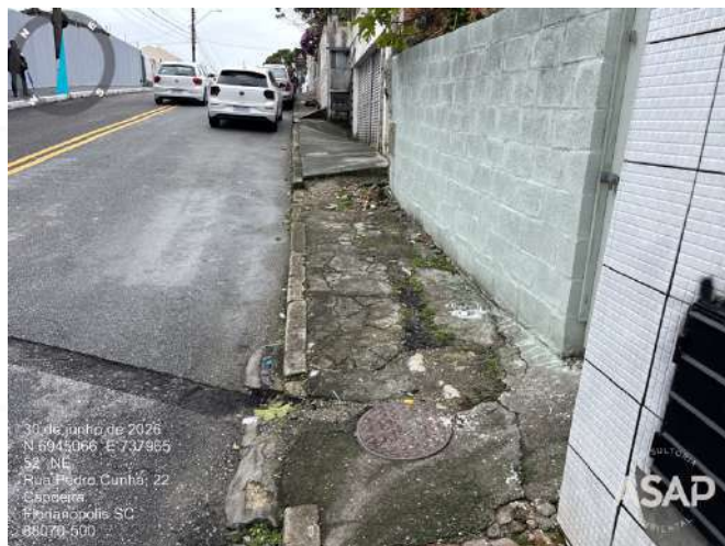
Foto 1.5. Trecho de passeio sem acessibilidade verificado na Rua Pedro Cunha. Fonte: ASAP, 2026.
