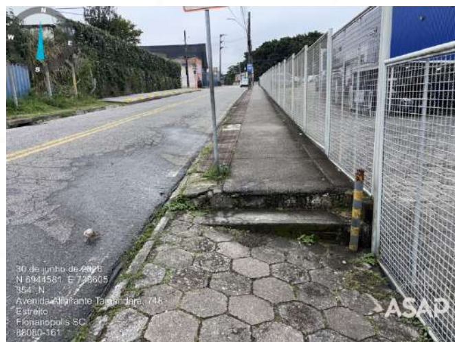
Foto 1.24. Trecho de passeio sem acessibilidade observado junto à Avenida Almirante Tamandaré. Fonte: ASAP, 2026.
