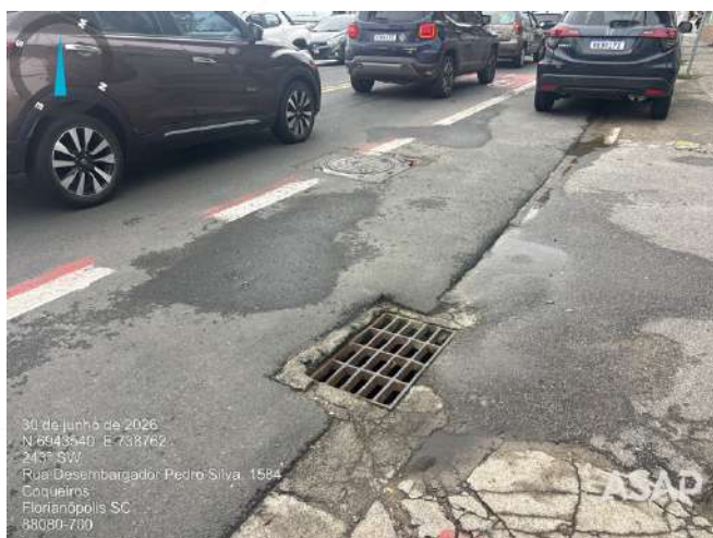
Foto 4.15. Bueiro em bom estado na Rua Desembargador Pedro Silva. Fonte: ASAP, 2026.
