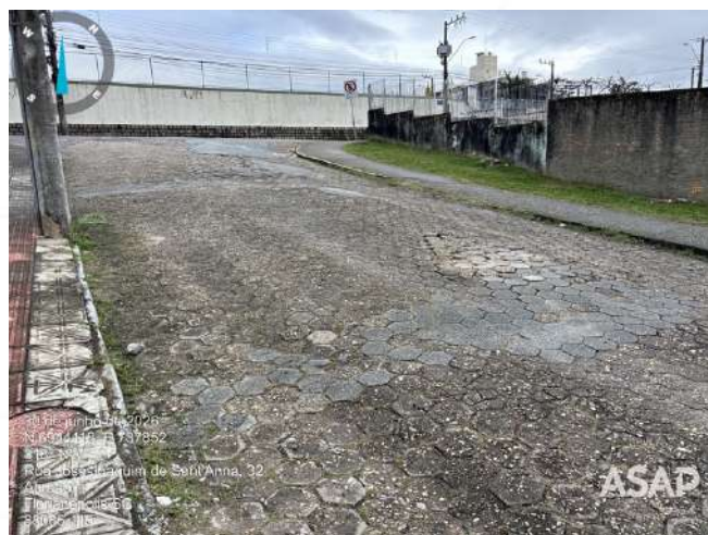
Foto 5.4. Pavimento em más condições na Rua José Joaquim de Santana. Fonte: ASAP, 2026.
