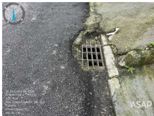
Foto 4.14. Bueiro verificado na Rua Celso Capella. Fonte: ASAP, 2026.
