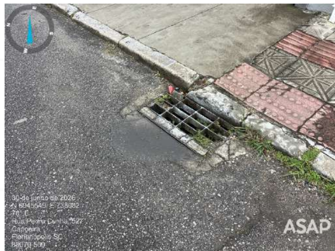
Foto 4.8. Bueiro na Rua Pedro Cunha. Fonte: ASAP, 2026.
