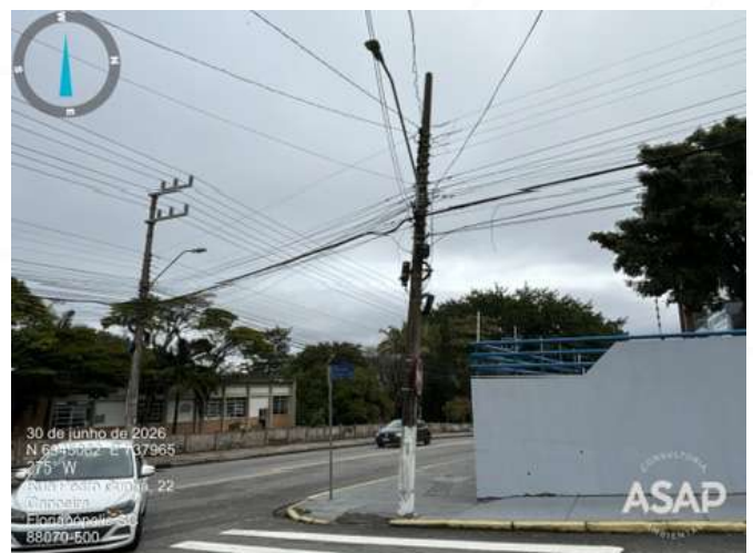
Foto 3.6. Iluminação em LED na Rua Pedro Cunha. Fonte: ASAP, 2026.
