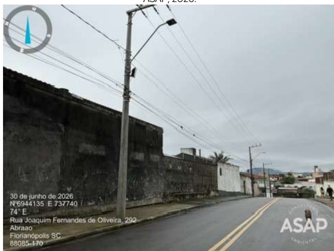
Foto 3.3. Iluminação em LED na R. Joaquim Fernandes de Oliveira. Fonte: ASAP, 2026
