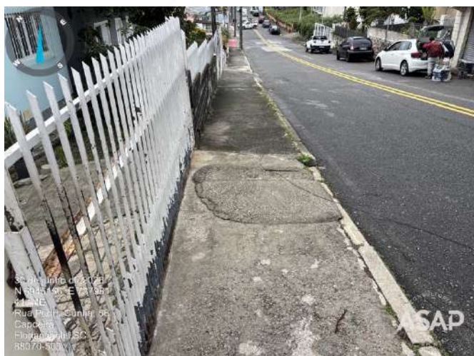
Foto 1.9. Trecho de passeio sem acessibilidade verificado na Rua Pedro Cunha. Fonte: ASAP, 2026.
