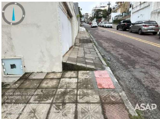
Foto 1.19. Trecho de passeio sem acessibilidade observado junto à Rua Fritz Muller. Fonte: ASAP, 2026.
