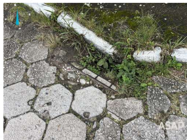
Foto 4.16. Bueiro em mal estado na Rua Juventino dos Santos Barbosa. Fonte: ASAP, 2026.
