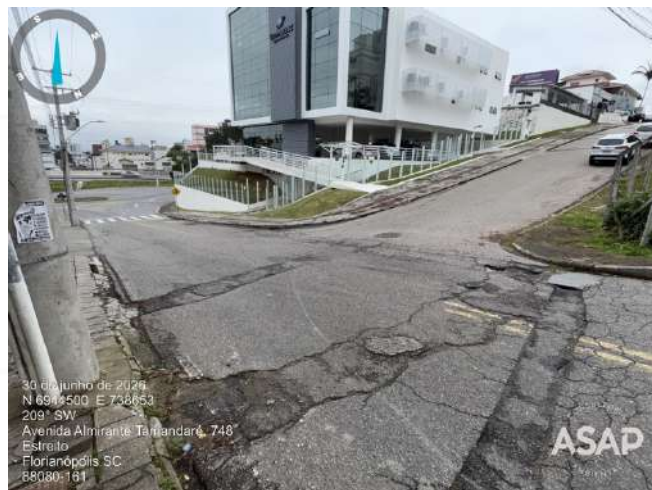
Foto 5.20. Pavimentação em mal estado na esquina da Travessa Aroldo Pessi com Avenida Almirante Tamandaré. Fonte: ASAP, 2026.
