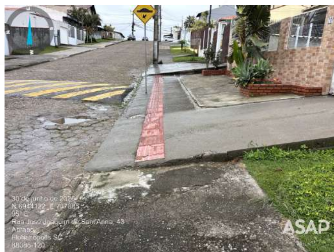
Foto 1.3. Passeio sem acessibilidade junto às Rua José Joaquim de Santana. Fonte: ASAP, 2026.
